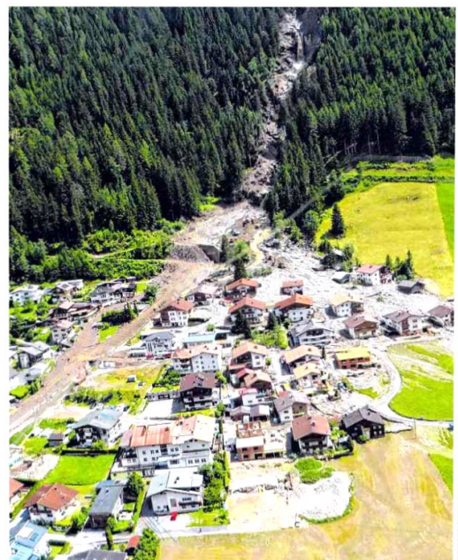
Mehrere Murgänge im Schallerbach führten im Sommer 2015 zu schweren Schäden in der Gemeinde See/Tirol – der neue, 2016 fertiggestellte Murbrecher ist 24 Meter hoch und schützt die Siedlung
